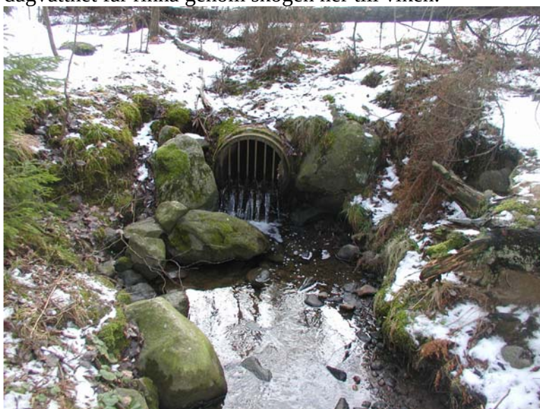
Figur 4. Dagvattenledning mynnar med detta rör i skogsparti strax söder om Södergarnsviken. Här har en mindre rännil/skogsbäck bildats på grund av dagvattnet.
