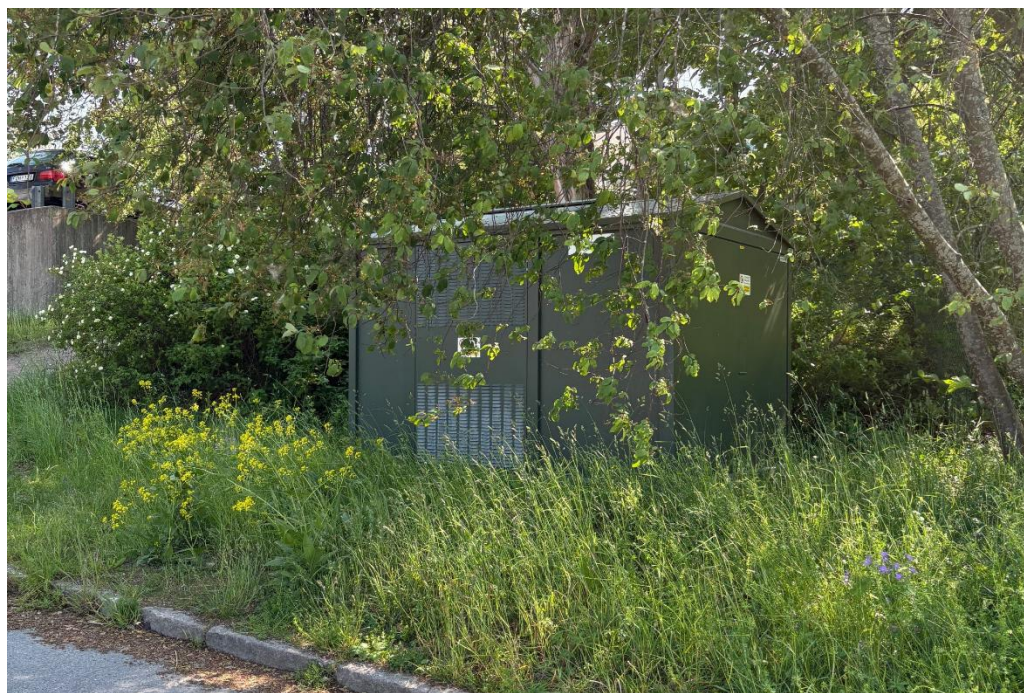
Transformatorstationen inom fastigheten. Foto: Lidingö stad.
