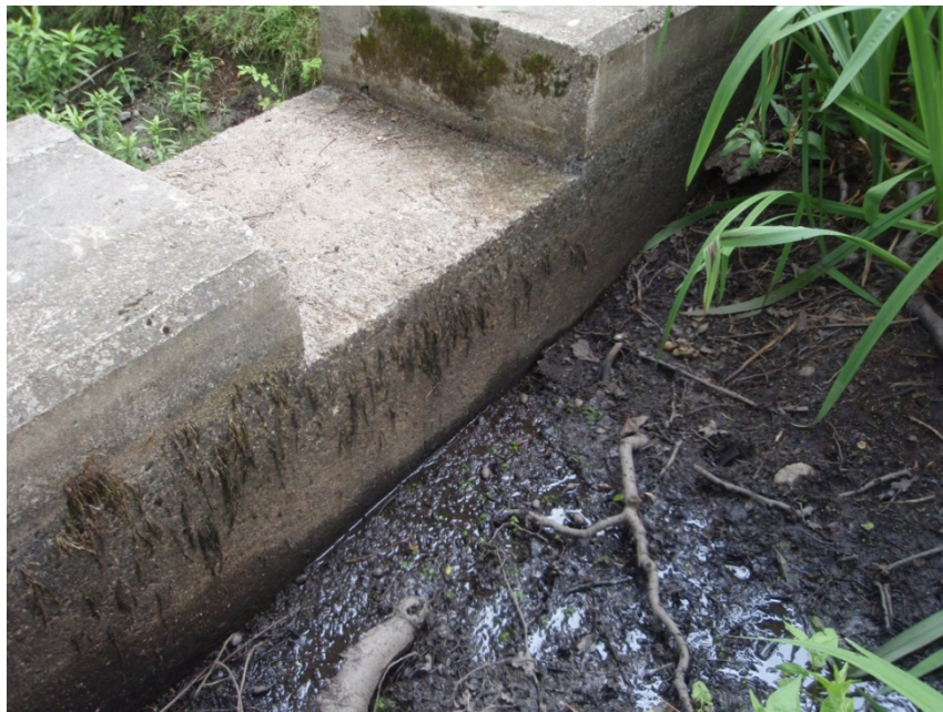
Bild 2. Uttorkat dämme från dammsidan 2014-06-27
