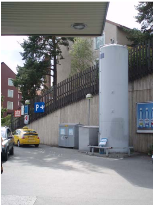
Figur 4.1. Plåtskåp för förvaring av gasol, samt dieselcistern.
