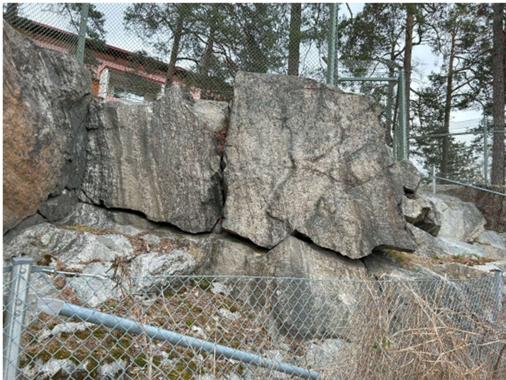
Exempel på område med risk för ras av lösa block i den östra delen av fastighet Vaktmästaren 8.
